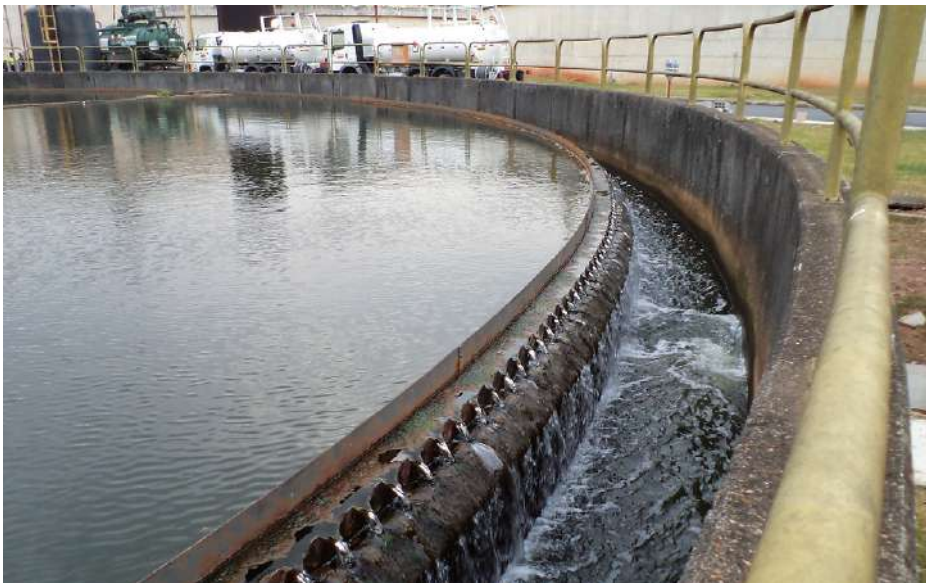
FIGURA 14. Esgoto tratado em ETE, em conformidade para ser lançado em corpo hídrico (Foto: Adriano L. Tonetti).
