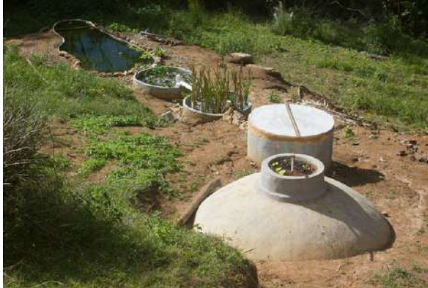
FIGURA 2. BSI que atende uma família e uma escola (Sítio Ko Yvy, Mury, RJ). O pós-tratamento do efluente do biodigestor é feito por dois filtros biológicos e um tanque de macrófitas (Projeto e foto: Tito Cals).
