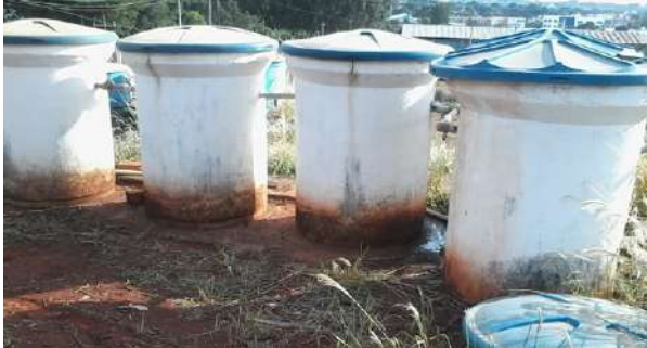
FIGURA 4. RAC instalado na FEAGRI/UNICAMP, Campinas-SP. O RAC é a primeira etapa do tratamento de esgoto de uma parte do campus. Depois do RAC o esgoto segue para SAC (Foto: Isabel Figueiredo).
