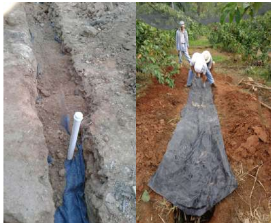
FIGURA 5. Material filtrante coberto com manta tipo bidim (no detalhe, o respiro e o reaterro) e lona plástica perfurada. Campinas-SP (Foto: Isabel Figueiredo).
