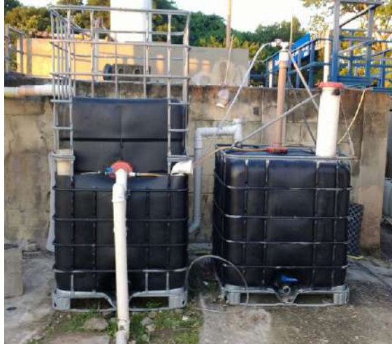
FIGURA 3. Biodigestor experimental de contêiner IBC (modelo Solar Cities) no Centro Experimental de Saneamento Ambiental da UFRJ (Foto: William Romanholi).
