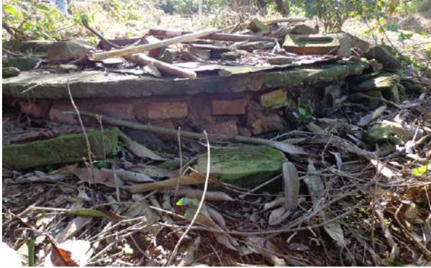
FIGURA 2. Sumidouro de tijolos vazados com tampa de concreto. Campinas-SP (Foto: Isabel Figueiredo).
