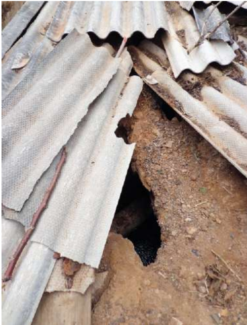
FIGURA 21A. Fossa absorvente com fechamento precário. Tampa de telha de fibrocimento (Foto: Isabel Figueiredo).
