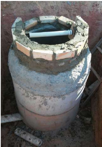
FIGURA 4. Biodigestor de anéis de concreto. Na imagem a cúpula está sendo construída com tijolos e suportará a tampa. A tubulação de PVC que chega na base é a entrada de esgoto (Foto e projeto: Guilherme Castagna).
