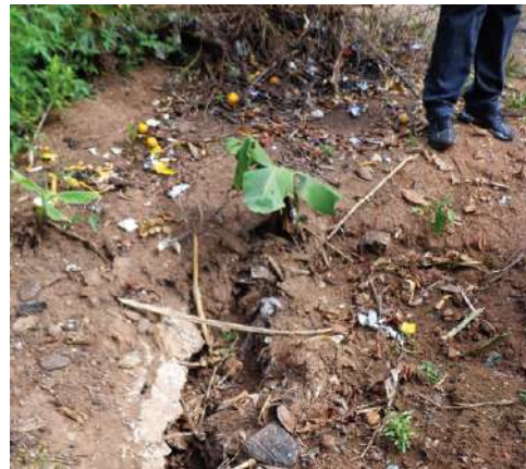
FIGURA 21B. Fossa absorvente com fechamento precário. Tampa de concreto que cedeu com as chuvas (Foto: Isabel Figueiredo).
