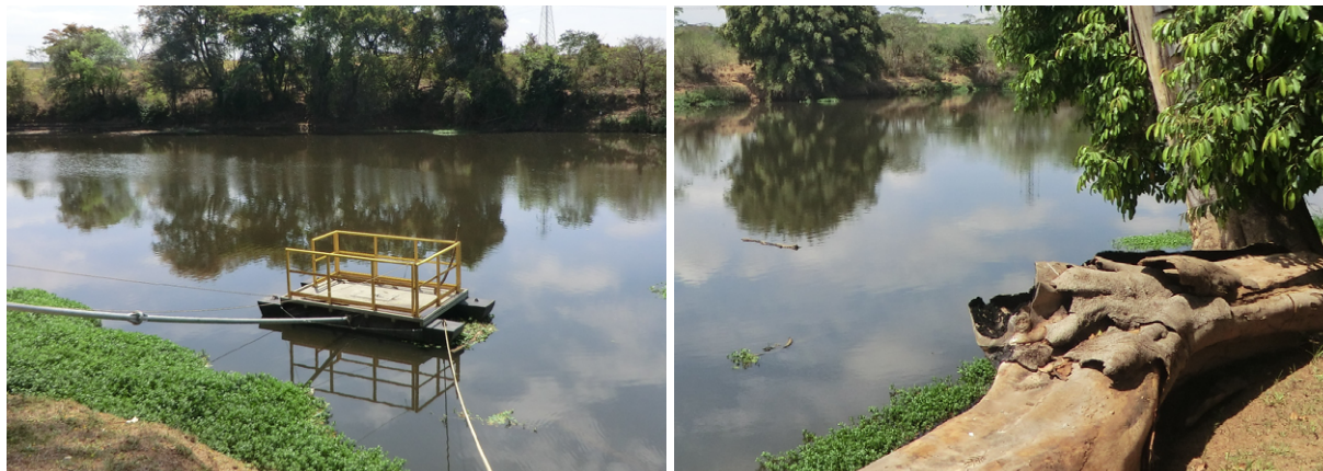
Figura 3.7 – EF-06 - PCAB 02600 – Vista do flutuante no Sítio Paudalinho, na estrada dos Marins, S/N, em Piracicaba
