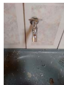
Torneira na residência da moradora da comunidade ponto- P3 (c)
