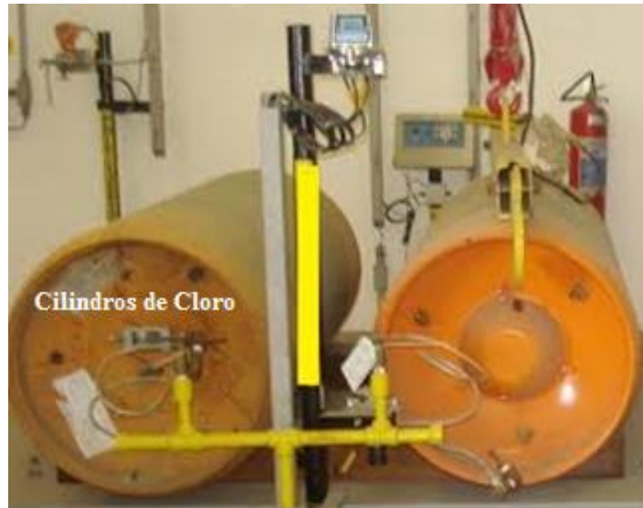
Figura 3.16. Cilindros de cloro armazenados em uma ETE
