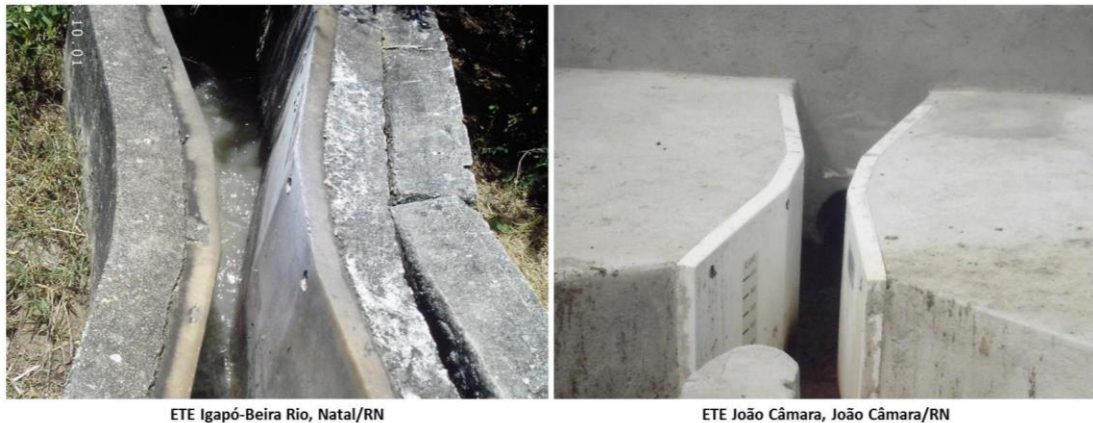
Figura 3.4. Calhas Parshall presentes em ETE's do estado do Rio Grande do Norte
