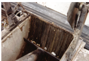
Grade de limpeza mecanizada
