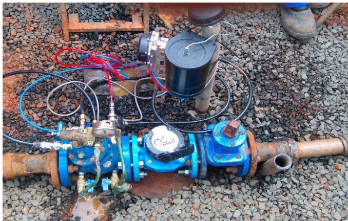
Figura 2: Macromedidor, VRP e sensor de pressão
