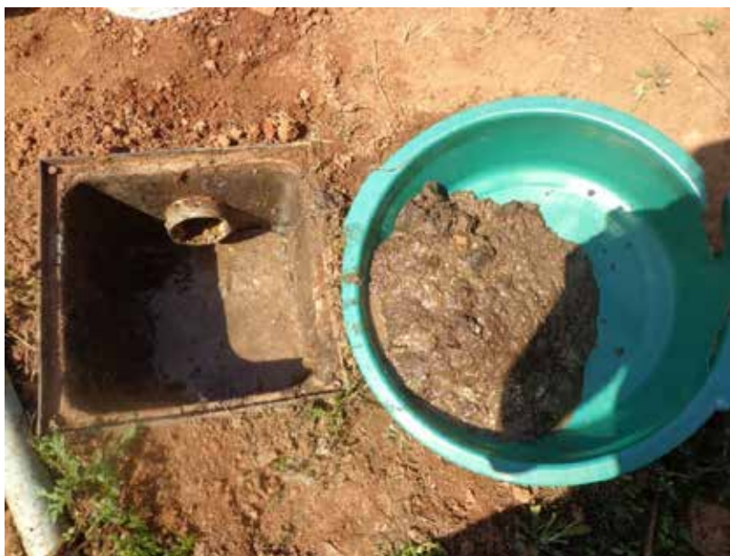
Figura 4 - Caixa de gordura instalada após a pia da cozinha. Na bacia ao lado encontram-se os sólidos retirados durante a limpeza semestral.
