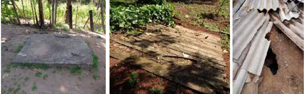
Figura 2 - Tipos de tampa para fossas rudimentares encontradas em área rural de Campinas (SP). Esquerda - Tampa de alvenaria; Centro - Tampa de madeira; Direita - Tampa com telhas de amianto. (Fonte: Figueiredo, 2019).
