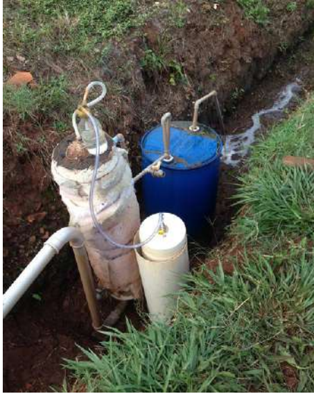
FIGURA 2. RAFA unifamiliar implantado em área rural. Este protótipo simplificado e de baixo custo encontra-se em fase de estudo em Botucatu-SP. Ele é confeccionado com tubo PVC 300mm (Foto: Guilherme Franceschini).
