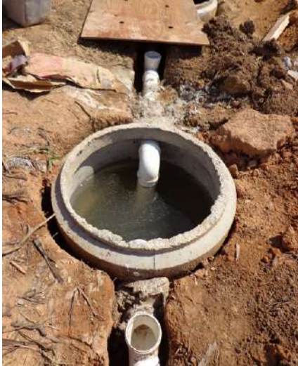
FIGURA 2. Tanque séptico (ainda sem a tampa instalada), construído em anéis de concreto. Campinas-SP (Foto: Isabel Figueiredo).
