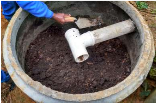
FIGURA 3. Vermifiltro construído com anéis de concreto (zimbras) em São Francisco Xavier-SP. Detalhe do Tê para distribuição do esgoto. Projeto Protegendo as Águas- SFX (Foto: Francisco Madrid).
