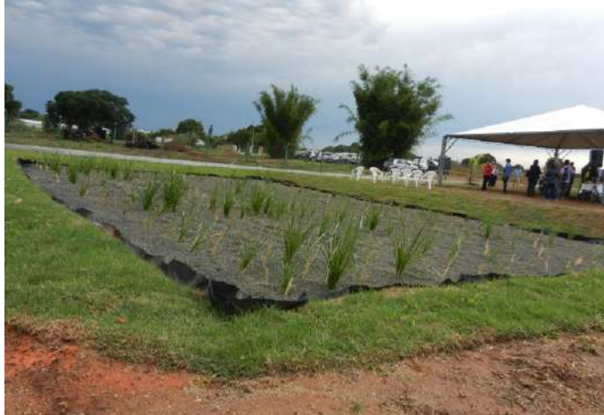
FIGURA 2. SAC com fluxo vertical e impermeabilização feita por manta de PVC em Holambra/SP (Foto: Isabel Figueiredo).
