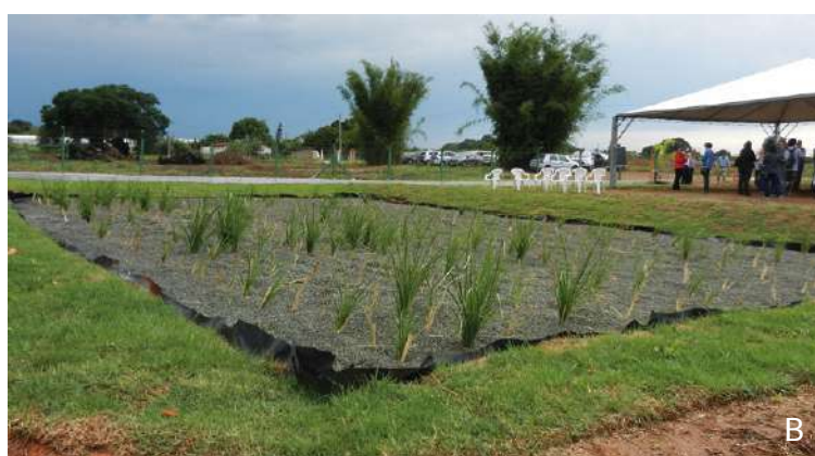
FIGURA 2. Exemplo de solução semicoletiva para tratamento de esgoto em comunidades isoladas. Tanques sépticos em série (A) e sistemas alagados construídos - SAC (B) implantados em Holambra-SP (Fotos: Isabel Figueiredo).
