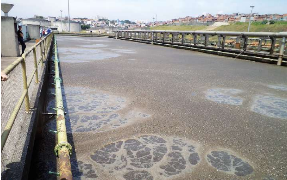
FIGURA 13. Processo de tratamento secundário de esgoto, com tecnologia conhecida como lodos ativados (Foto: Adriano L. Tonetti).
