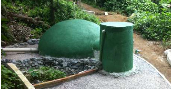
FIGURA 2. Biodigestor de alvenaria, integrante de um BSI (T15) para tratamento de esgoto do Vale Encantado- RJ. (Projeto: Otávio Barros e Valmir Fachini. Foto: Leonardo Adler).
