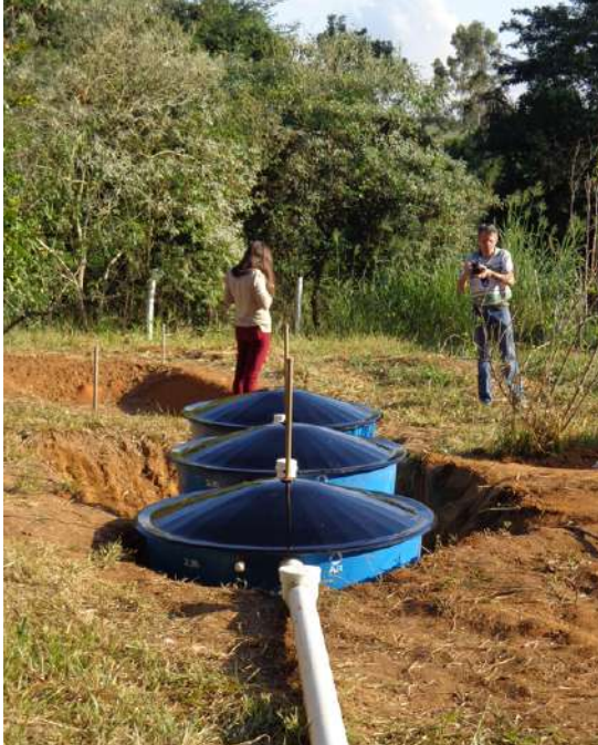
FIGURA 2. FSB instalada em Holambra-SP. As caixas de fibra tiveram suas tampas pintadas de preto (Foto: Isabel Figueiredo).
