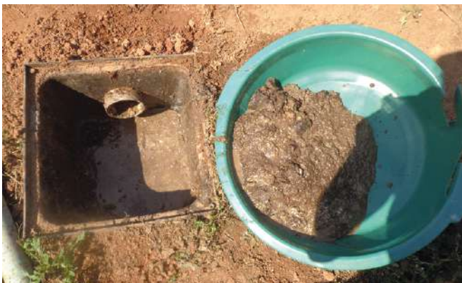
FIGURA 19C. Resíduo removido de dentro de uma caixa de gordura de uma residência na zona rural após seis meses de uso (Foto: Isabel Figueiredo).
