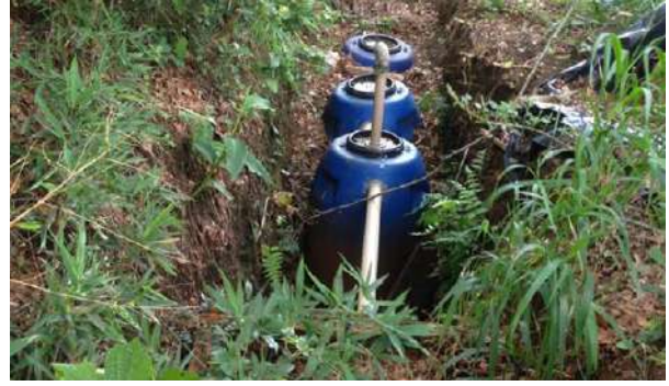
FIGURA 3. RAC construído com bombonas plásticas de 220L, compondo o sistema conhecido como Fossa séptica econômica (Foto: Guilherme Franceschini).
