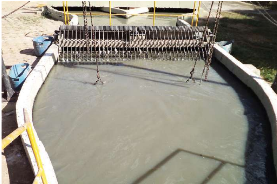
FIGURA 12. Gradeamento em ETE (Foto: Adriano L. Tonetti).
