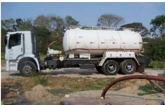
FIGURA 4. Caminhão tipo “limpa-fossa” fazendo a limpeza programada do tanque séptico, conforme definido em projeto. Campinas-SP (Foto: Luana Cruz).
