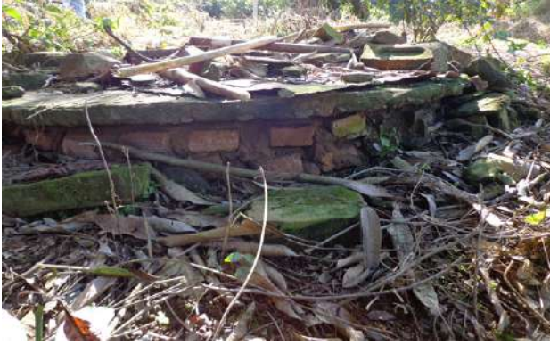
FIGURA 2. Sumidouro de tijolos vazados com tampa de concreto. Campinas-SP (Foto: Isabel Figueiredo).
