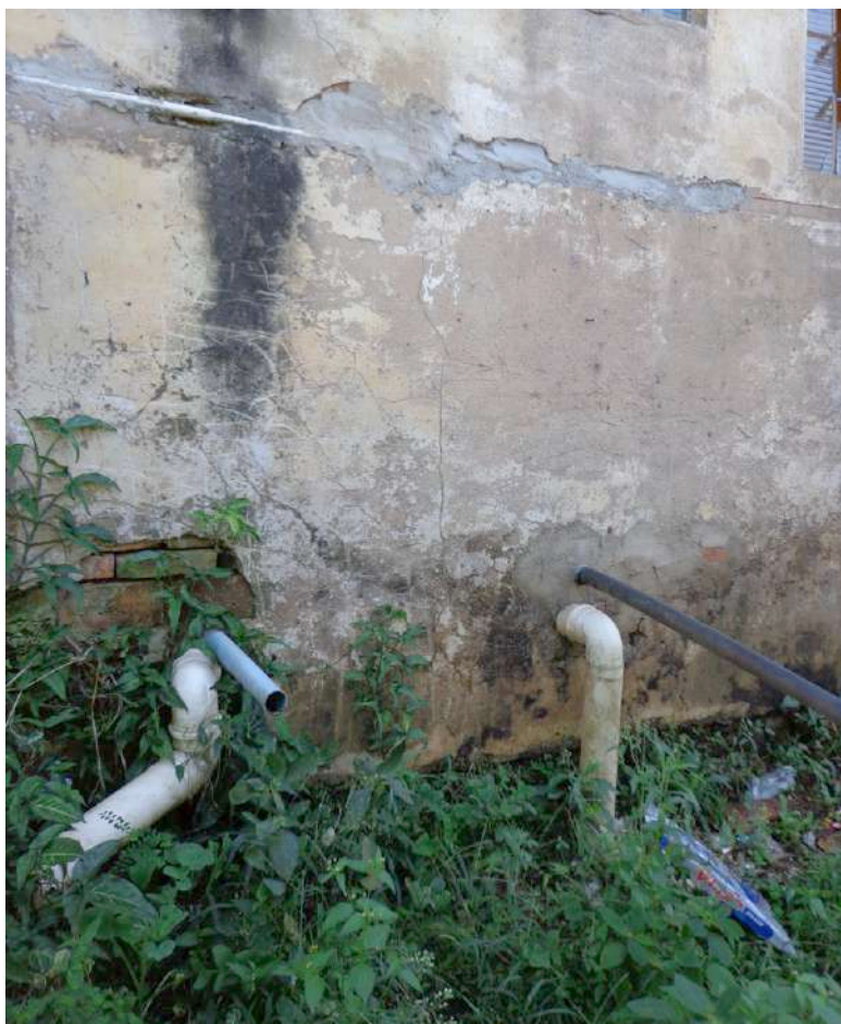
FIGURA 15. Encanamento na parte externa do domicílio mostrando a segregação do esgoto em pelo menos duas frações distintas: águas cinzas (mangueiras flexíveis pretas e tubos azuis) e águas de vaso sanitário (tubulação branca de PVC) (Foto: Isabel Figueiredo).
