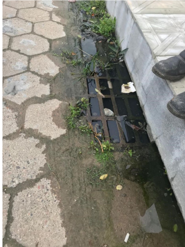
Figura 5 – boca de lobo entupida – UTP 13.
