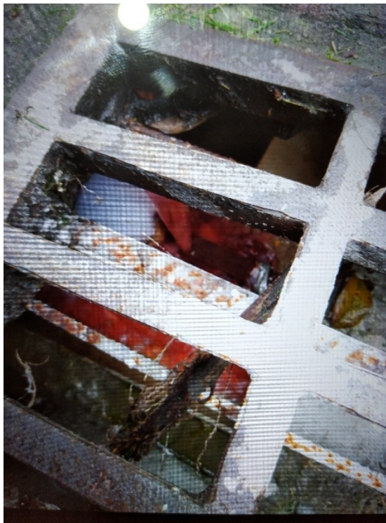
Figura 4 – Corante vermelho indicando o lançamento de esgoto clandestino na drenagem pluvial – UTP 13.
