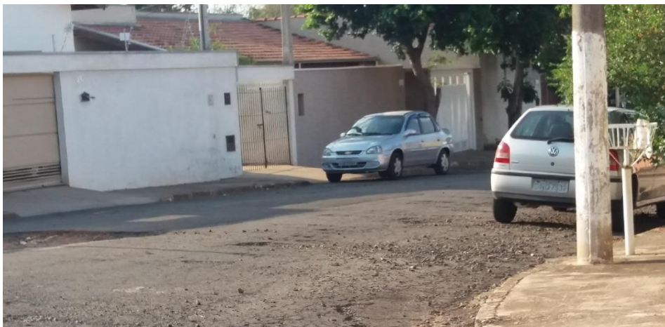
Figura 8: Deterioração do asfalto no Jardim Sylvania.
